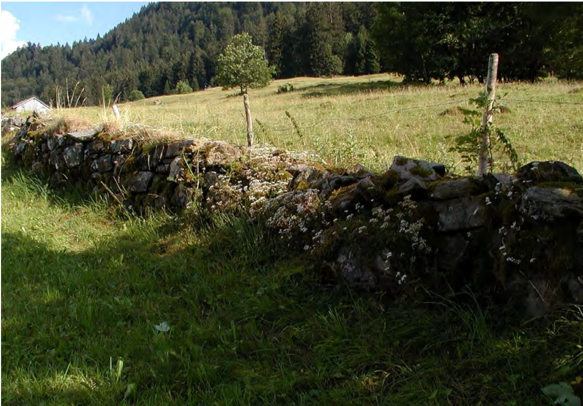
Die Feldmauer oberhalb Argenau mit schönen Populationen des Weißen Mauerpfeffers ( Sedum album ).
